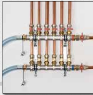
Lämpöpatteri- ja pintalämmitysjärjestelmien huuhtelu (S/SL/SLW)
